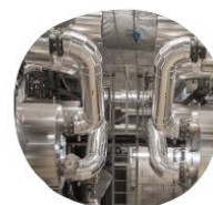
RÉCUPÉRATION CHALEUR FATALE
